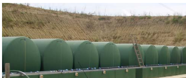
Cisterne stoccaggio percolato MAD
